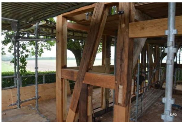
Store dele af bindingsværket tog skade efter en renovering i 50'erne, hvor fugt trængte ind i træet. Nu bliver det gamle træ, der er i god stand, bevaret, mens man skifter det træ, der har taget varig skade. Foto: Sandra Goldek
